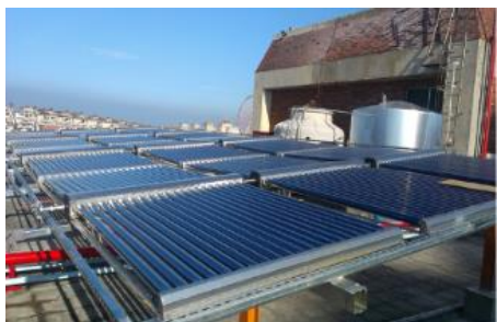
天然氣鍋爐熱水系統改善為太陽能加熱泵熱水系統
