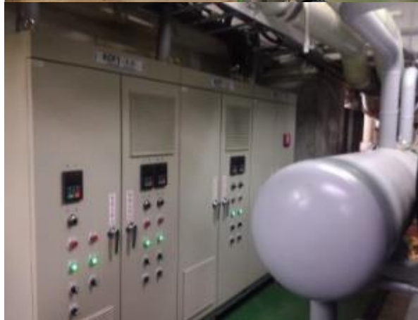
定頻及變頻併用之雙壓縮機 螺旋冰水主機
